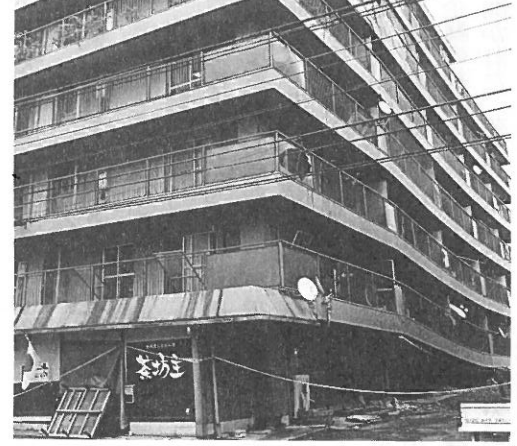
1階吹き抜け部の駐車場が座屈して2階部分が崩れ落ちているマンション。阪神大震災の時も指摘されたように吹き抜け構造の弱点であるが、今回も同様の被害が見られる (於・熊本市西区・撮影: 若原キヌコ)
